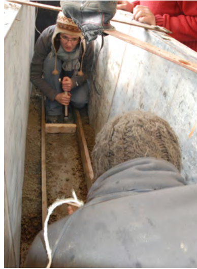
2 Mise en place de planches pour maintenir le mélange terre-ciment en périphérie
