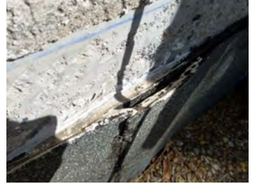
Etanchéité des terrasses à revoir
