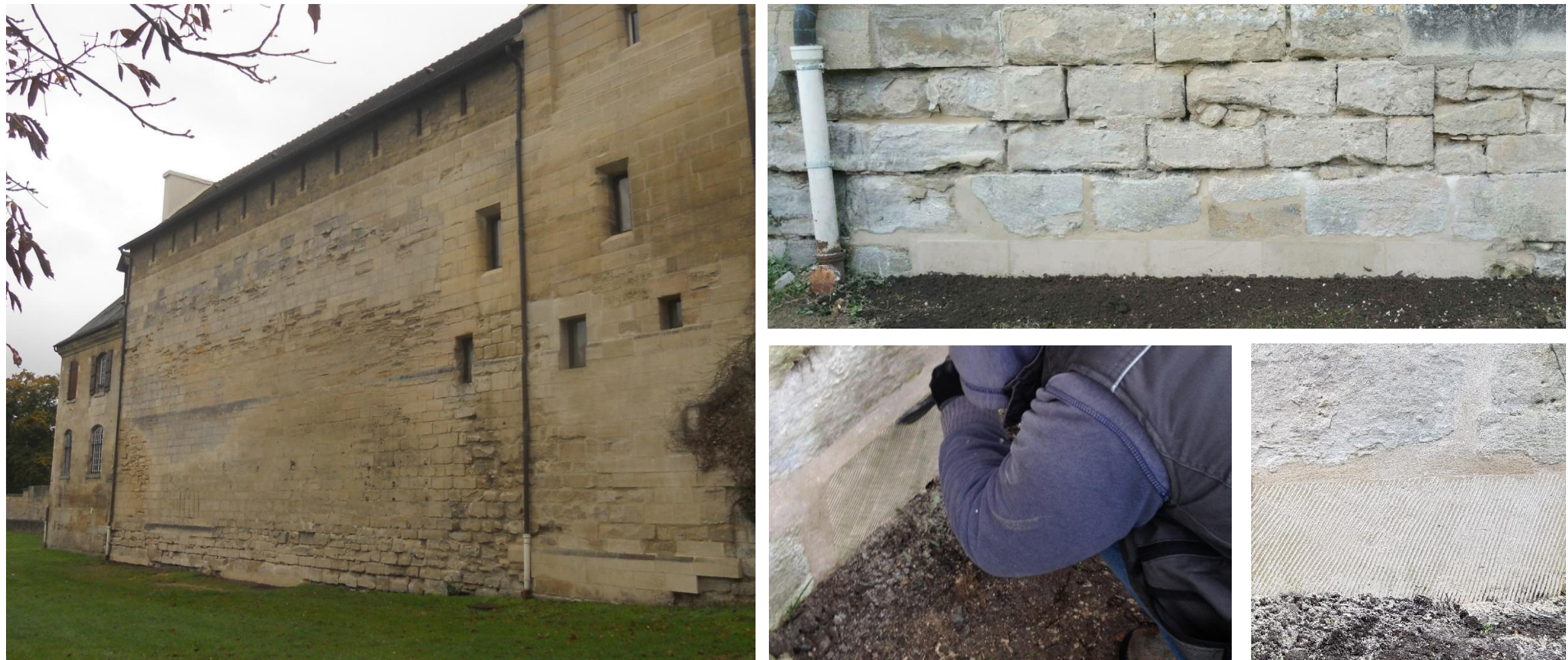
Rejointoiement ponctuelle de la première assise en attente des travaux à venir pour la restauration complète des cinq premières assises du soubassement, Dégrossissage des parements neufs par taille à la gradine à 6 dents
