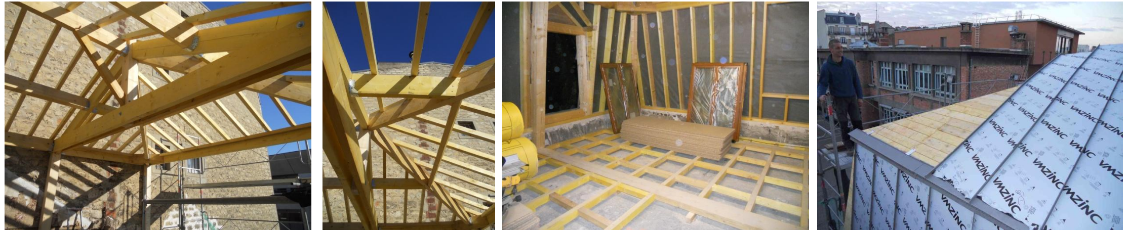
Phases de mise en œuvre d'une charpente traditionnelle et d'un plancher en bois de sapin, isolation, voligeage et couverture en zinc à joint débout avec ligne de bris ventilé
