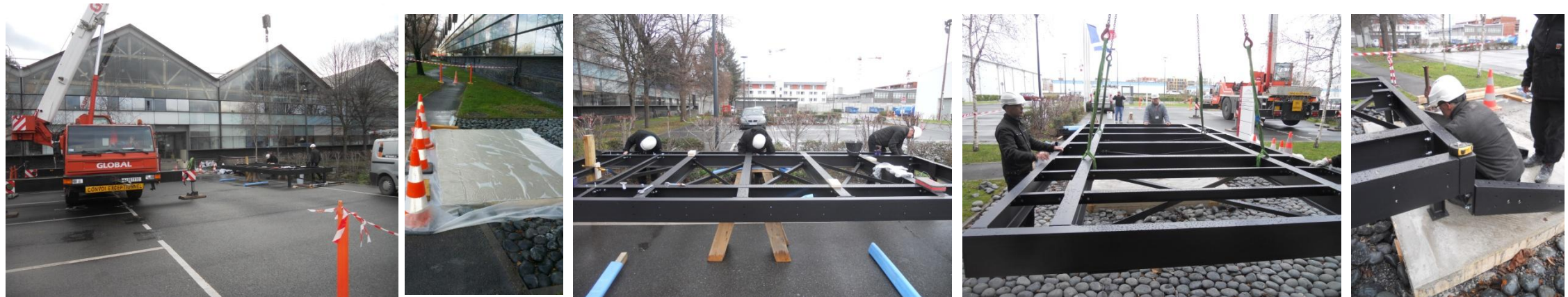
Phases de préparation au levage et ancrage de la charpente métallique sur radier en béton armé
