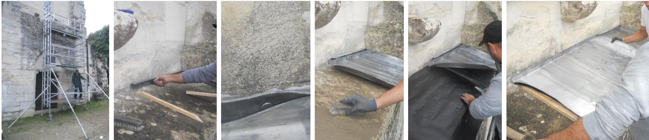
Echafaudage roulant contreventé au sol, bandes d'agrafes périphériques et tasseaux arrondis, clous calotins pour fixer la bande d'agrafe périphérique dans les joints verticaux de la pierre, brossage du glacis après dévitalisation des colonies végétales et mise en œuvre du papier anglais, préparation de la forme de couverture et assemblage
