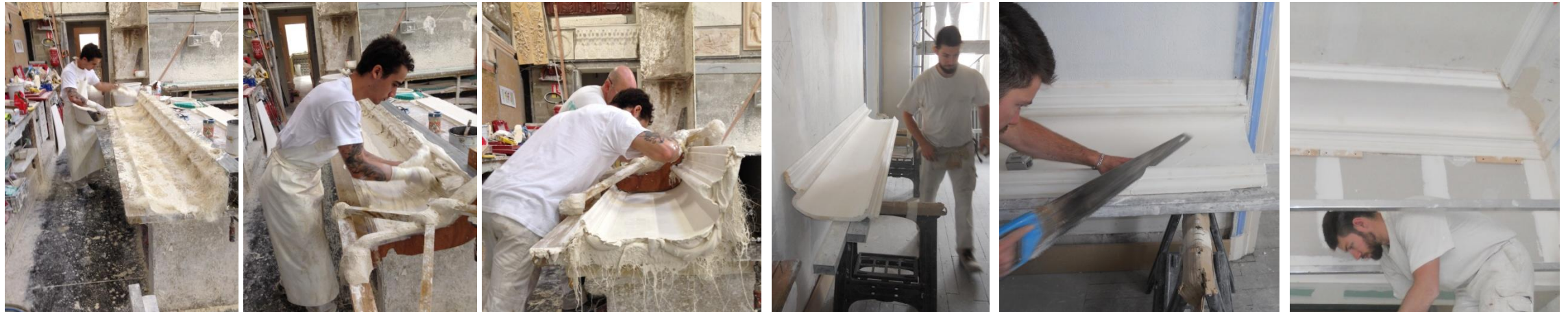
Phases de fabrication d'une corniche de plafond en staff en atelier ; pose et raccord sur existant
