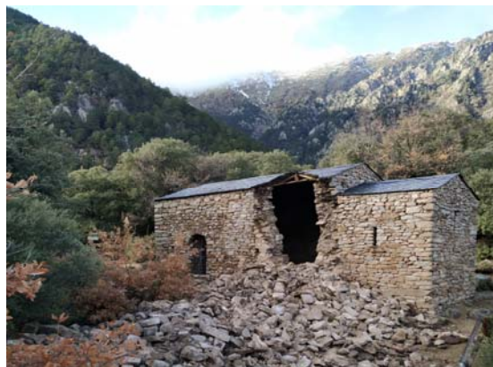
Figure 5. Vue du clocher après son effondrement.
