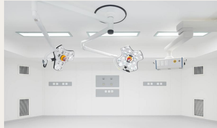
BLOC OPÉRATOIRE DE LA CLINIQUE BRÉTÉCHÉ À NANTES
